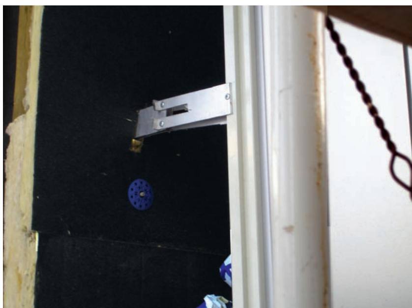
Фото 3. Удлинение кронштейна произведено с нарушением технологии, предусмотренной разработчиком фасадной системы. Возможно обрушение фасадной системы
