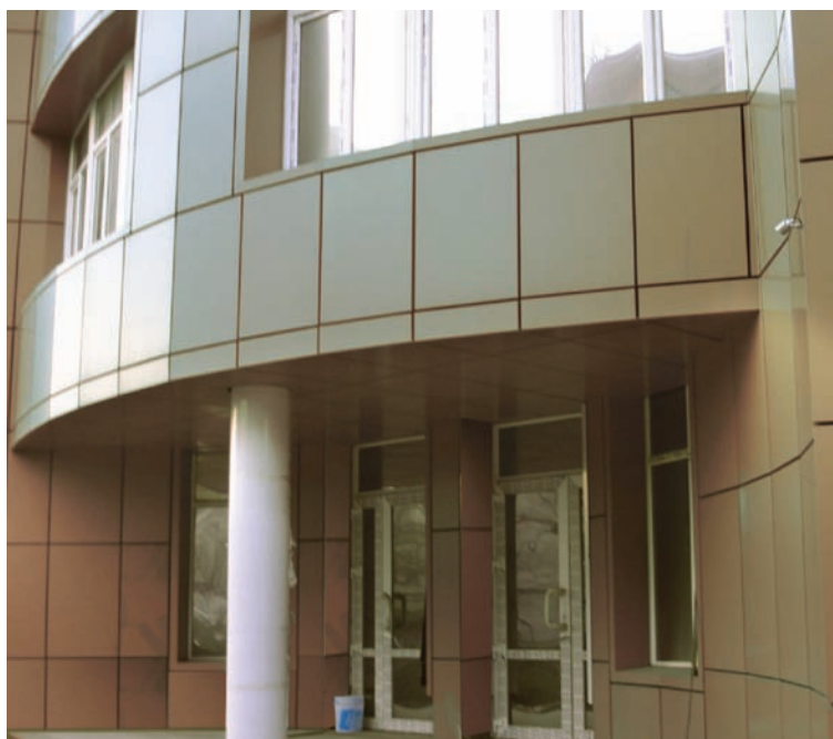
Фото 19. Пример нарушения требований пожарной безопасности: алюминиевыми композитными панелями выполнено обрамление верхних и боковых откосов оконных и дверных проемов, а также облицовка снизу навесов и козырьков
