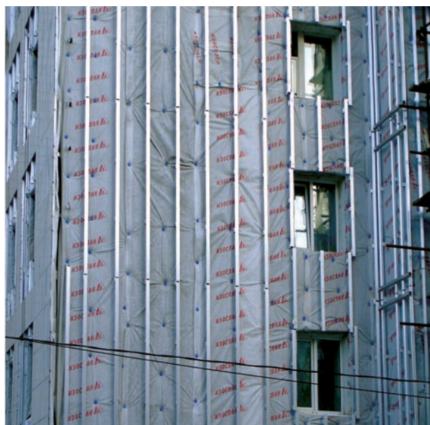
Фото 12. Пример нарушения требований пожарной безопасности: используется ветрозащитная пленка, не разрешенная к применению в составе данной фасадной системы; отсутствуют противопожарные отсеки
