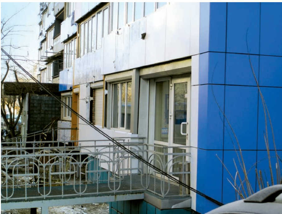
Фото 20. Пример нарушения требований пожарной безопасности: над эвакуационным выходом отсутствует навес (козырек) из ударопрочных материалов
