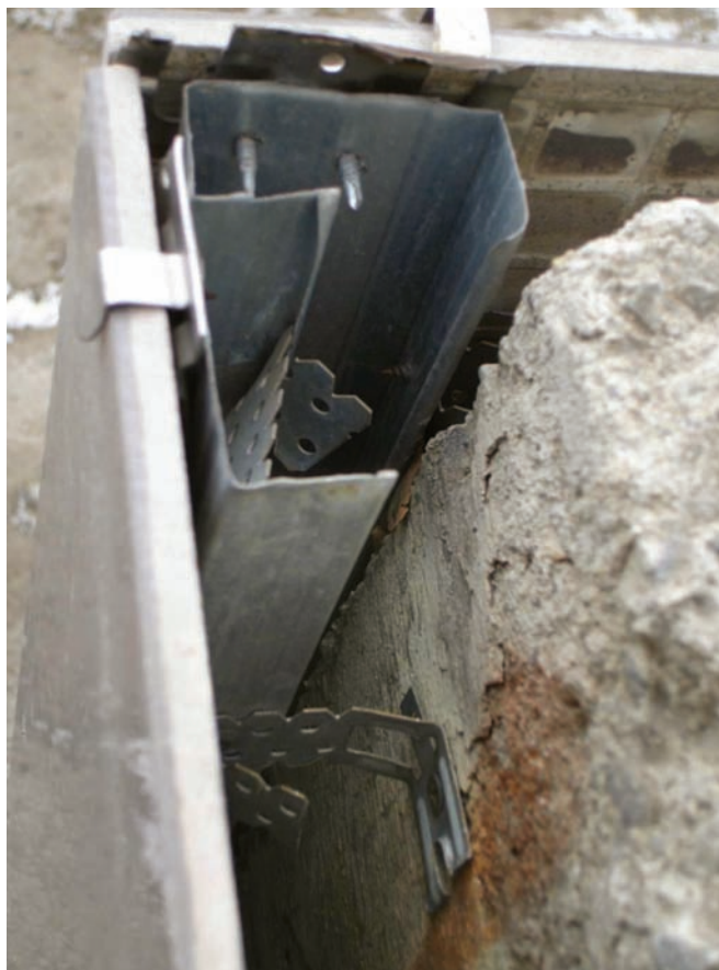
Фото 4. В качестве основных элементов несущей под облицовочной системы (профили и кронштейны) используется металлокаркас, предназначенный для гипсокартона. Обрушение фасадной системы неизбежно
