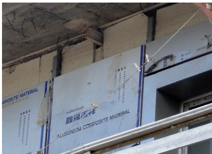
Фото 14. Пример нарушения требований пожарной безопасности: применяются горючий утеплитель и сильногорючие композитные панели. Обрамление оконных откосов выполнено композитными панелями в нарушение требований пожарной безопасности
