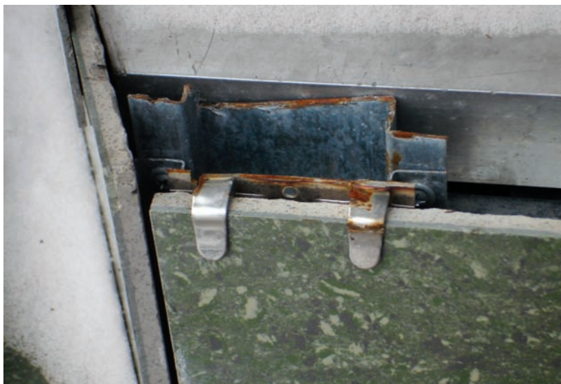
Фото 6. Коррозионное разрушение цинкового покрытия площадки и лапок кляммера. Дальнейшая эксплуатация данного крепежного элемента недопустима
