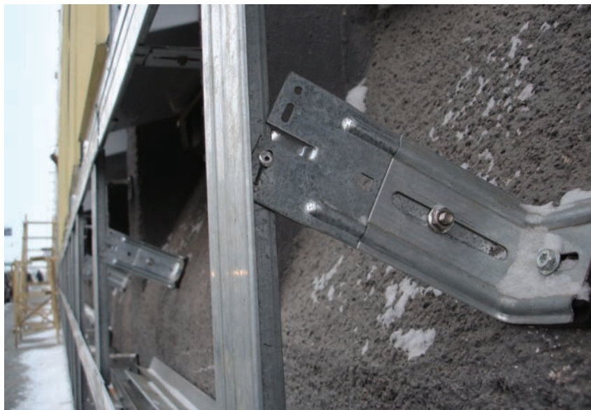
Фото 2. Установка кронштейнов и соединение их с вертикальными направляющими несущего каркаса выполнены с нарушением технологии, предусмотренной разработчиком фасадной системы
