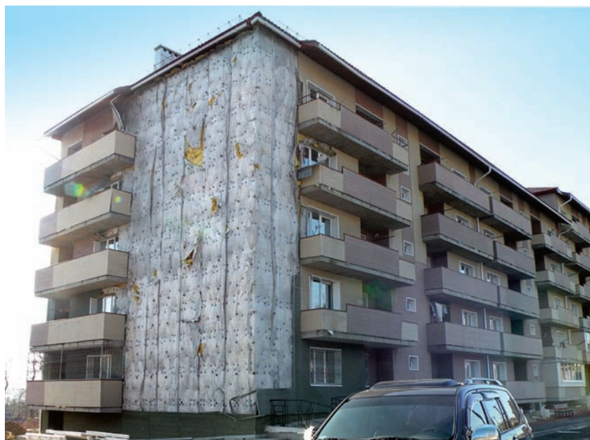
Фото 1. Здание с обвалившимся фасадом. Приморский край
