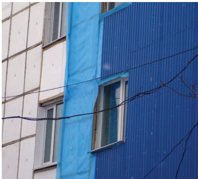
Фото 13. Пример нарушения требований пожарной безопасности: применяются горючий утеплитель, которым облицована не только основная плоскость фасада, но даже оконные откосы. Между листами полистирола – деревянные бруски, а сверху – горючая ветрозащитная пленка
