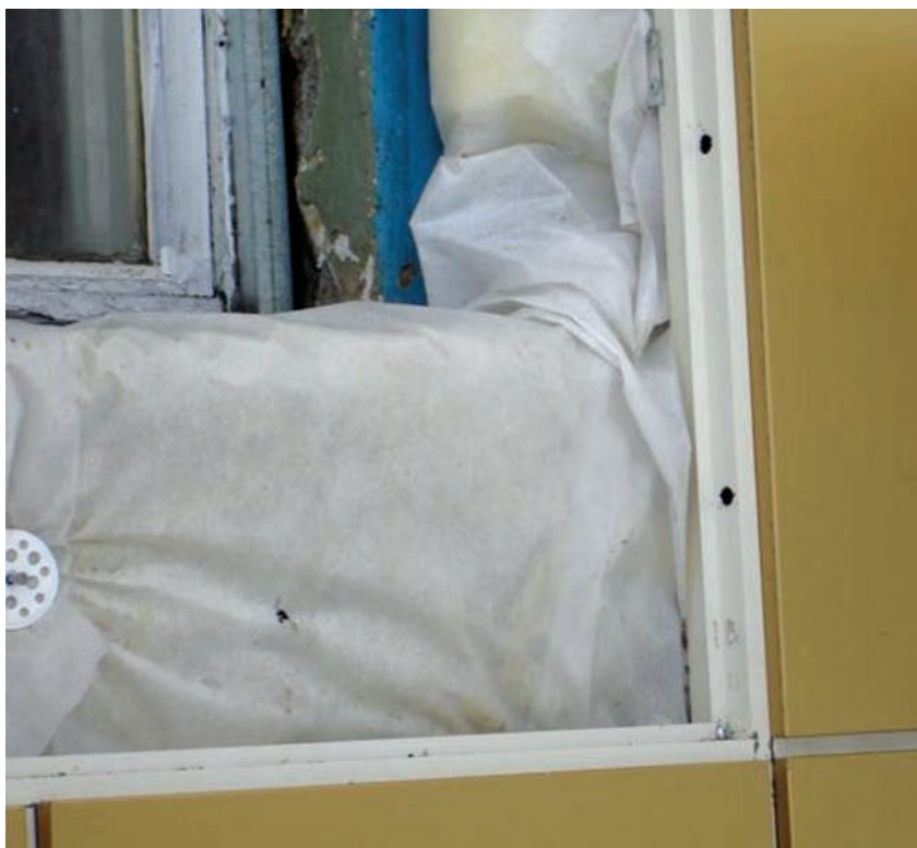
Фото 5. Отсутствие вентиляционного зазора способствует увлажнению утеплителя, следствием чего будет промерзание стен, появление грибка в квартире, ускоренное коррозионное разрушение несущей конструкции. Кроме того, намокание утеплителя увеличивает его массу и может привести к обрушению конструкции
