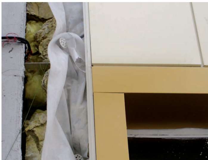
Фото 15. Пример нарушения требований пожарной безопасности: применяются утеплители из штапельного стекловолокна небольшой плотности. Нарушены требования по прокладке электрического кабеля и облицовке оконных откосов
