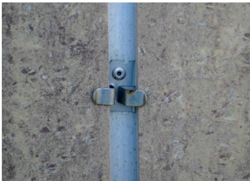
Фото 7. Начало процесса коррозионного разрушения оцинкованного кляммера, установленного на алюминиевом каркасе. Опасный контакт разнородных материалов, составляющих гальванопару
