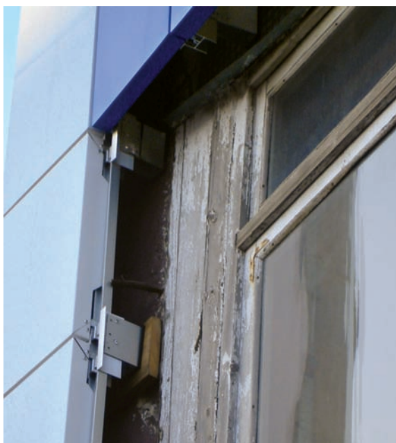
Фото 18. Пример нарушения требований пожарной безопасности: отсутствует локальная теплоизоляция алюминиевых кронштейнов
