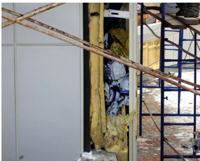
Фото 16. Пример нарушения требований пожарной безопасности: наличие горючих пленок под облицовкой делает фасад пожароопасным
