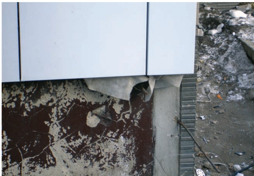
Фото 17. Пример нарушения требований пожарной безопасности: горячая ветрозащитная мембрана свисает из-под экрана облицовки
